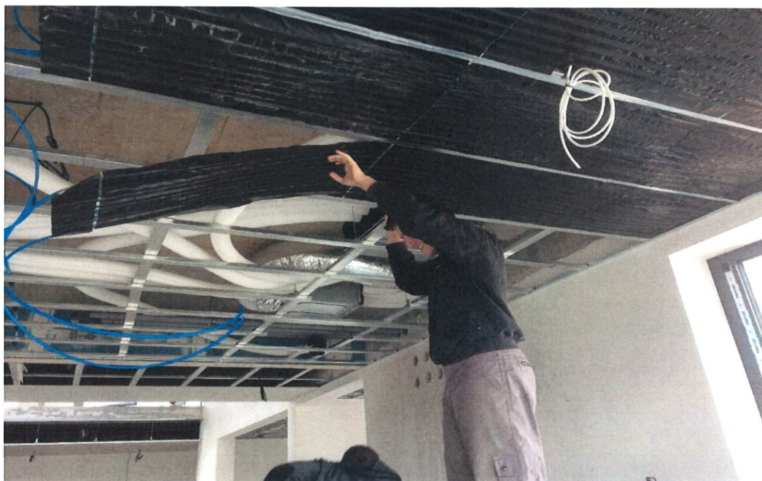
Foto: Instalace chladicího systému CoolFLEX
